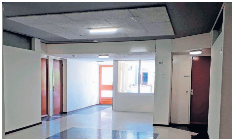
▲ De galerijgang op de derde verdieping waar vorig jaar brand ontstond doordat spullen vlam vatten.
